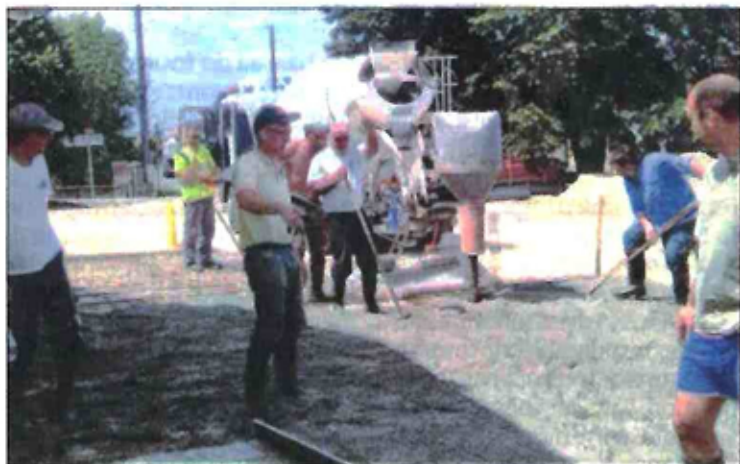
Élus et bénévoles coulent la chape en béton sur le parvis de la salle des fêtes. PHOTO P. I.
